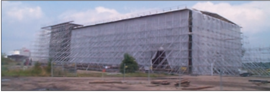
Thiuram vor der Sanierung
