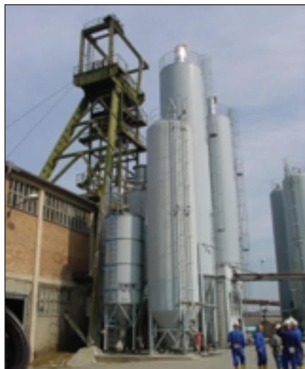
GVV, Versatzmischanlage Elbingerode
